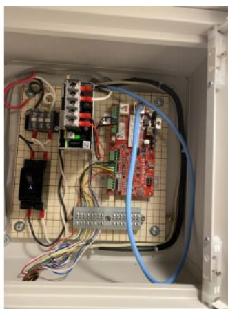
コントロールボックス内
