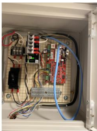
コントロールボックス内
