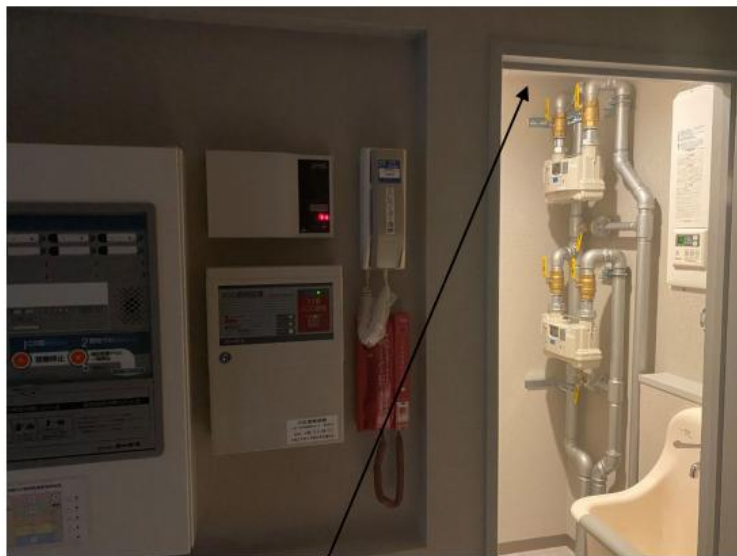
コントロールボックス
